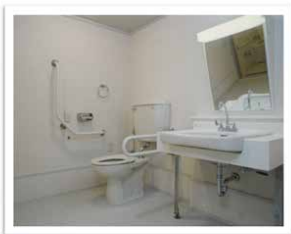
障がい者用居室のトイレ
